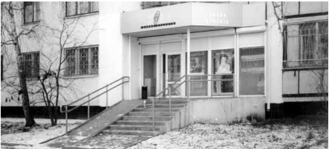
9. Пандус не оборудован перилами со второй стороны
